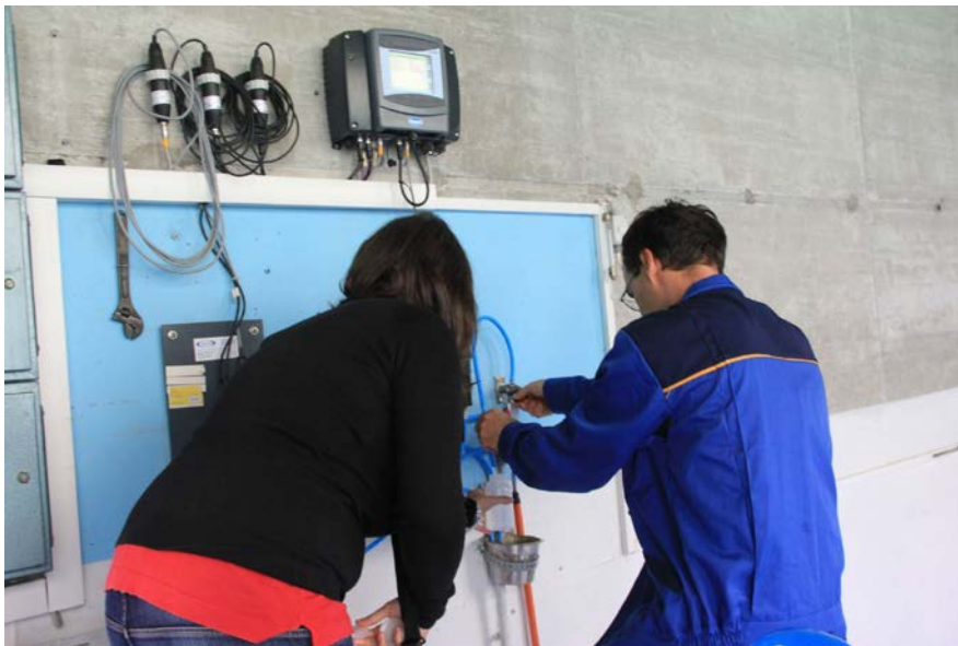
Merjenje fizikalnih parametrov in zajem vzorcev vode za kemijske analize na črpališču Mrzlek.
